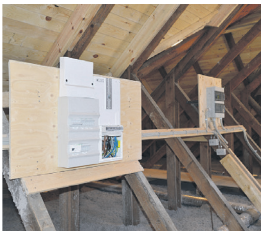
På loftet er fællestavlerne og sektionafbrydere udskiftet, så elforsyningen til lejlighederne nu stemmer overens med nutidens forbrugsmønstre.
