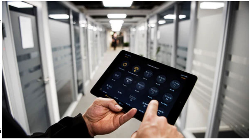
iPad'en er et helt centralt arbejdsredskab for Jonas Blicher, som bruger tid på at programmere og lave de korrekte indstillinger til belysningen.
