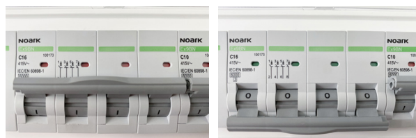
Når betjeningsgrebet vender opad er installationen tilkoblet (indikator viser rødt), og når grebet vender nedad, er den enkelte installationsgruppe afbrudt (indikator viser grønt).
