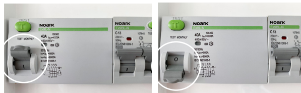
Når betjeningsgrebet vender opad er installationen tilkoblet, og når grebet vender nedad, er installationen afbrudt.
